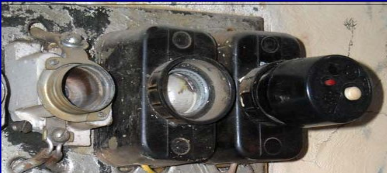
Пробочные предохранители и щиток старого образца
